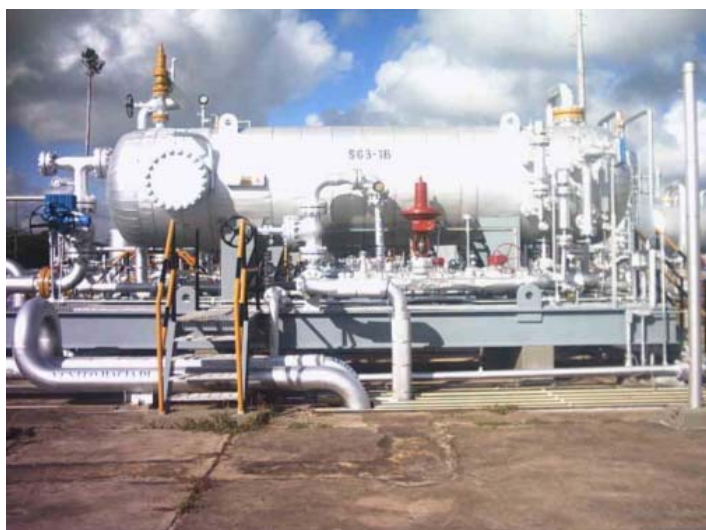
Figura 2.3 Separador horizontal bifásico.
