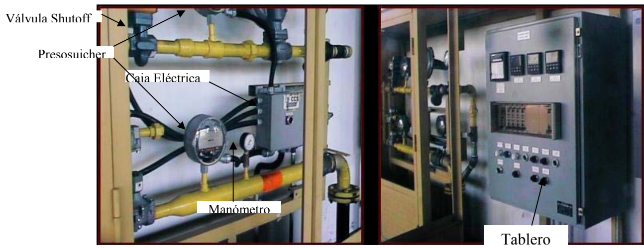
Fig. 3: Tablero y Ductos de Gas
