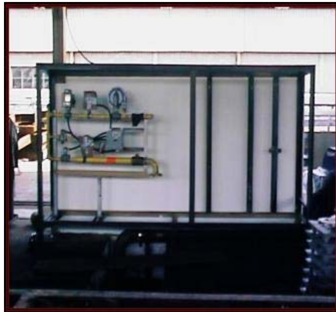
Fig. 4: Cabina de Control
