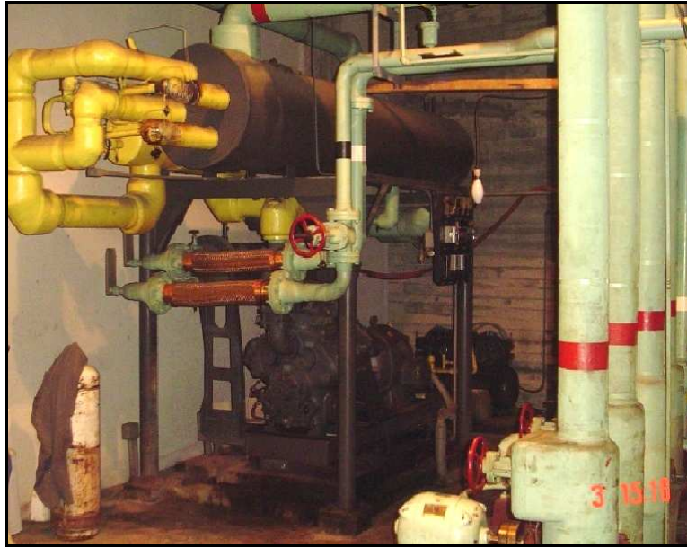
Figura 4.11: Sala de Maquinas del Sistema de Acondicionamiento de Aire. Fuente: Los Autores.
