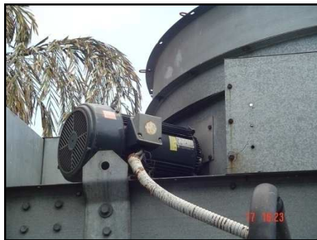
Figura 4.20: Motor eléctrico de la Torre de Enfriamiento. Fuente: Los Autores
