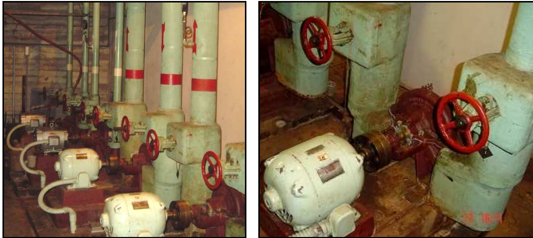
Figura 4.16: Tren de Bombas y detalle de bomba de Agua Helada. Fuente: Los Autores.
