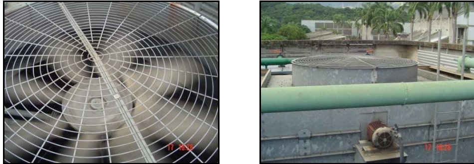
Figura 4.19: Ventilador axial de la Torre de Enfriamiento. Fuente: Los Autores.
