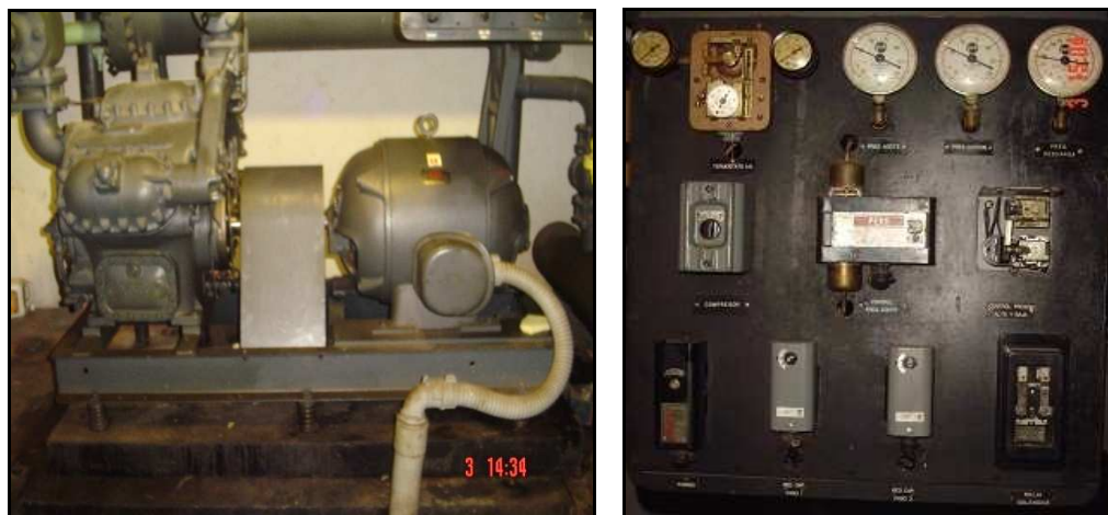
Figura 4.13: Motor, Compresor y panel de control del Chiller. Fuente: Los Autores.
