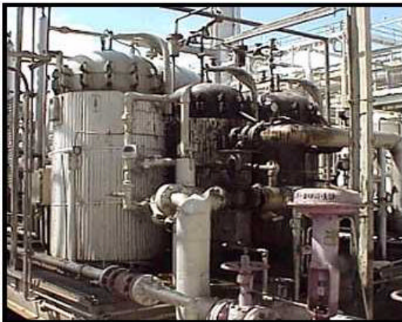
fig. 2.15 (Vista de los filtros mecánicos)
