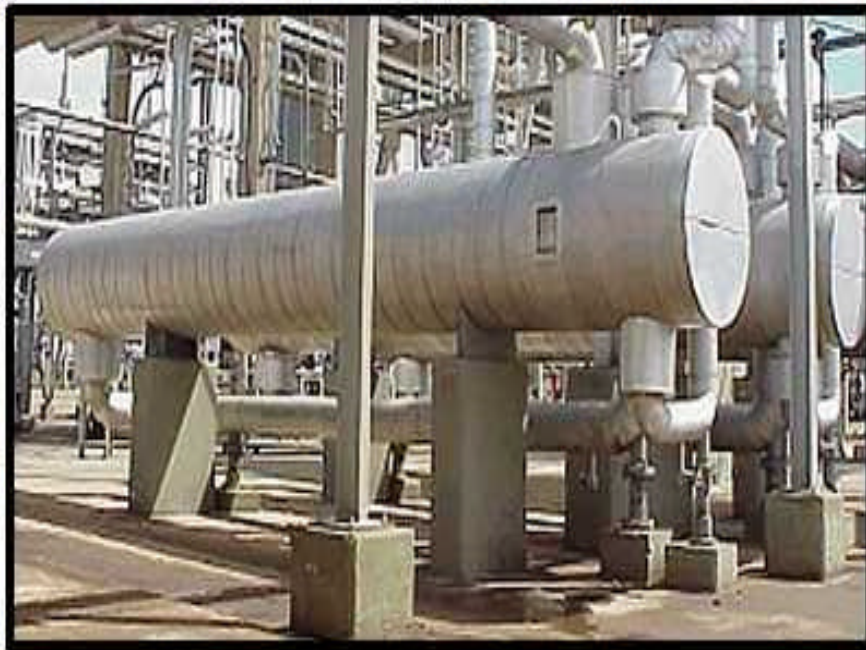
fig. 2.7 (Vista de los intercambiadores de glicol rico/pobre)
