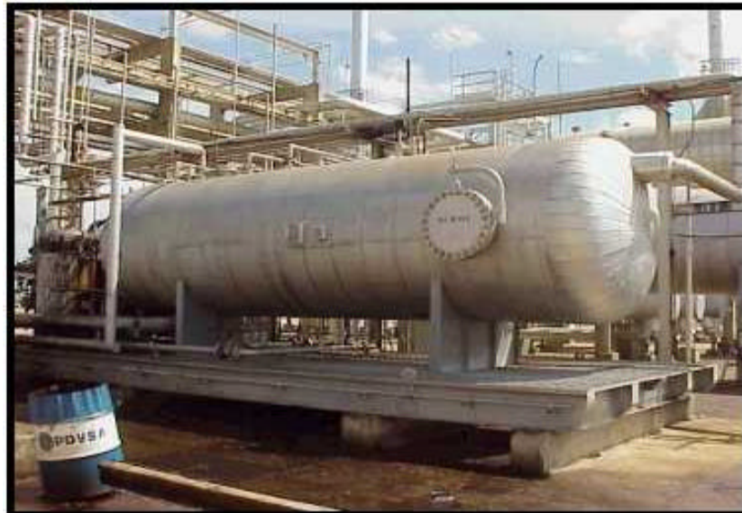
fig. 2.13 (Vista del tanque flash)
