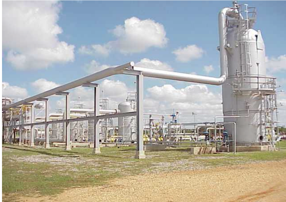
fig. 1.7 (Separadores de gas de entrada)
