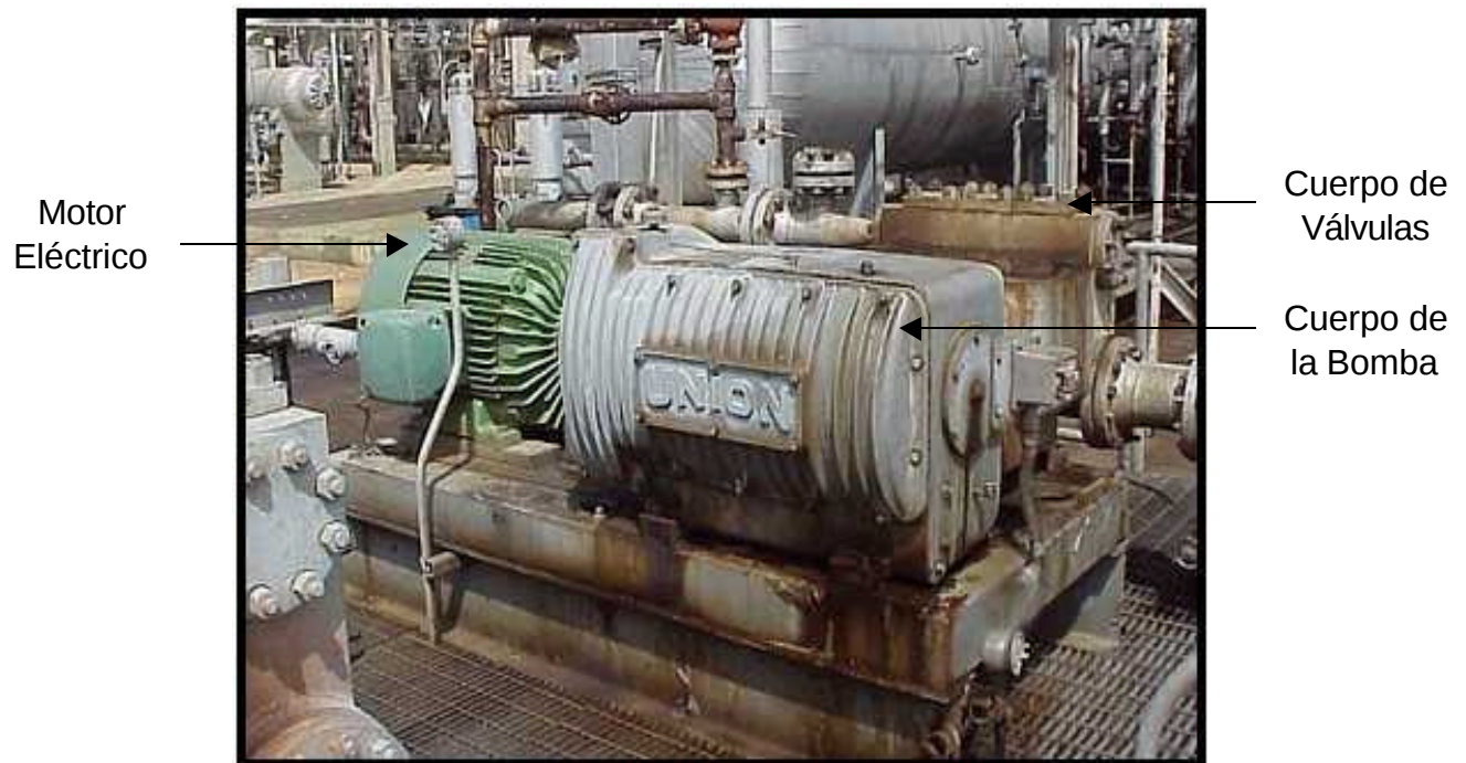
fig. 2.11 (Vista de las bombas de glicol)
