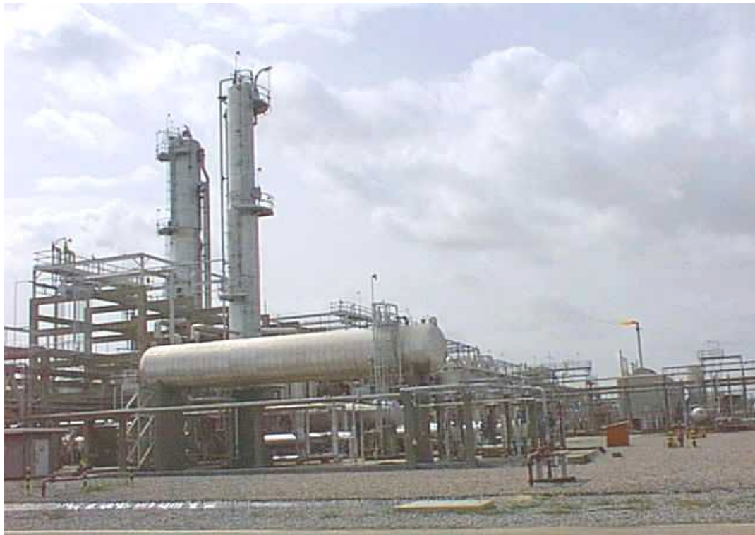
fig. 1.6 (Vista del tren A de la Planta de Extracción San Joaquín)
