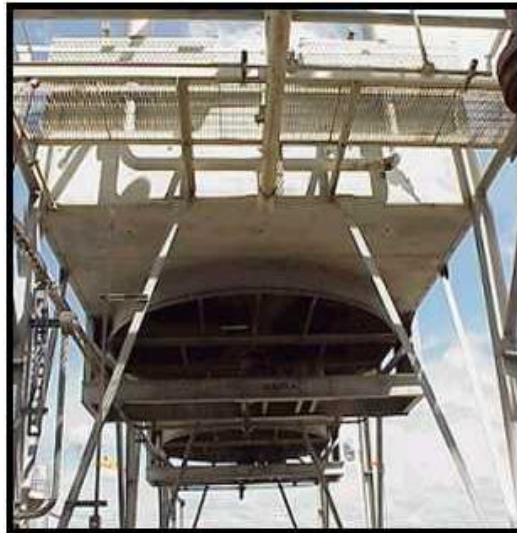
fig. 2.9 (Vista del enfriador)
