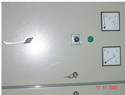
Figura 74. Tablero principal de potencia
