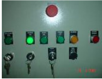
Figura 51. Luces y botones del tablero de control (Control PLC)
