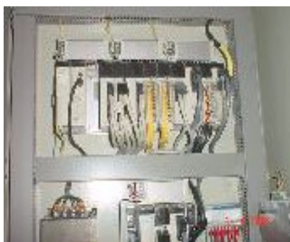
Figura 43. PLC en el tablero de control
