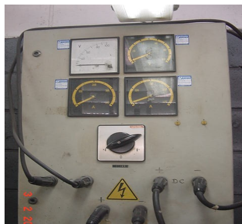
Fig. 15. Tablero de Control
