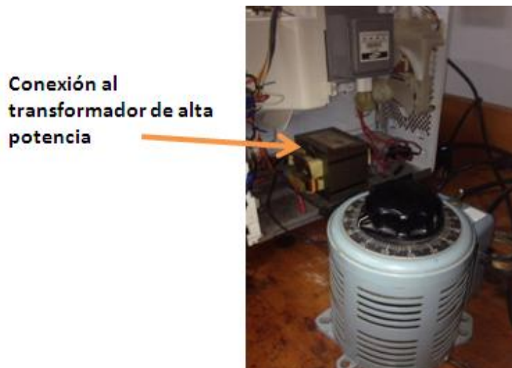
Fig. 56 Conexión del variac al transformador de alta potencia.
