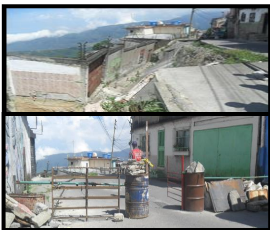
Imagen 8: Derrumbe asociado a falla de borde
