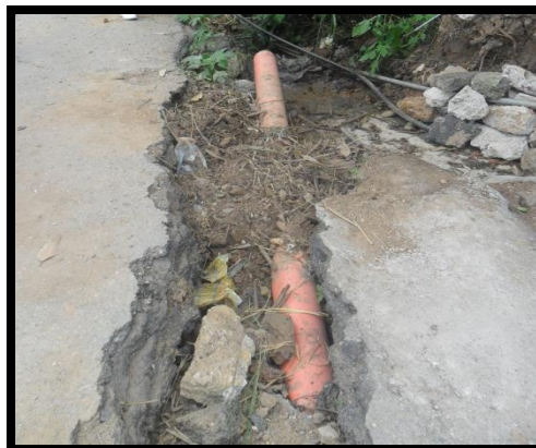
Imagen 14: Estado de la canalización de aguas servidas (sector Nuevo Horizonte)
