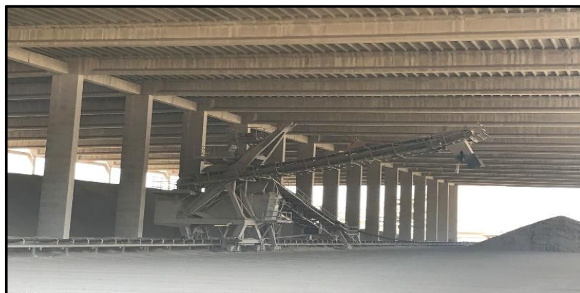
Figura N°10. Apilador del Patio de Almacenamiento de Caliza.
