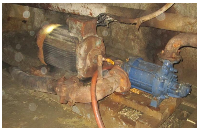
Figura 12. Bomba KSB WKL 50/5, Nivel 1, Mina Colombia Septiembre 2017.
