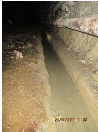
Fig. 17. Drenaje de la galería principal nivel 1 mina Colombia, septiembre 2017.
