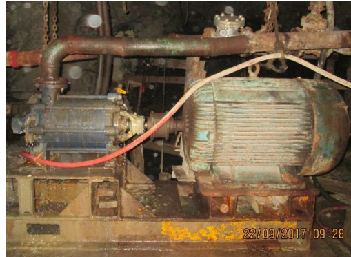
Fig. 15. Bomba KSB WKL 80/4, Nivel 4, Mina Colombia. Septiembre 2017.
