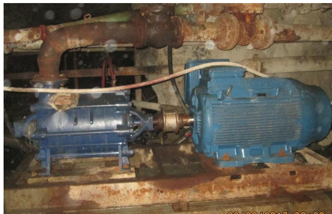
Fig. 14. Bomba KSB WKL 125/4, Nivel 4, Mina Colombia. Septiembre 2017.
