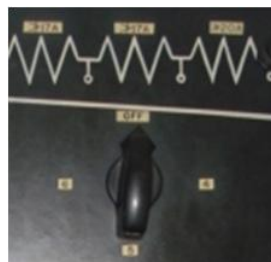
Figura 31. Reajuste de un interruptor en el tablero de control y operaciones.
