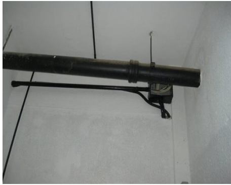
Figura B11. Tubería de aguas negras y cableado eléctrico
