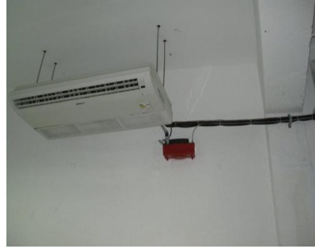
Figura B6. Aire acondicionado
