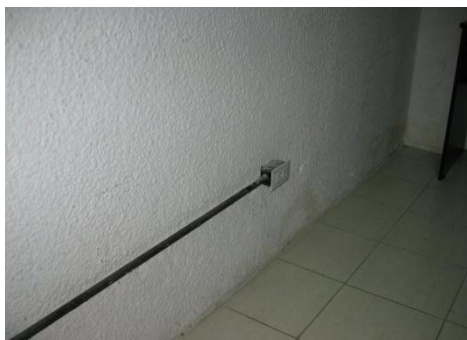
Figura B13. Presencia de humedad
