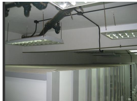
Figura B8. Iluminación y tuberías de aguas negras y servidas
