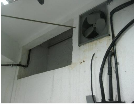
Figura B5. Presencia de filtración en paredes y cableado del cajetín eléctrico
