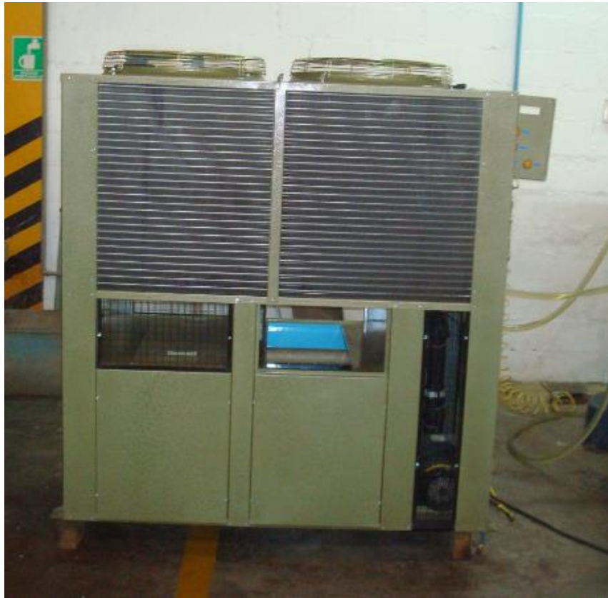
FIGURA 30.- Enfriador de agua de 10 toneladas ( chiller ).
