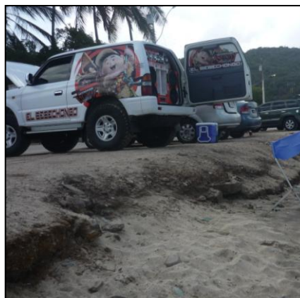
Fotografía 45. Evidencia del socavamiento marino y sus afectaciones en la vía.
