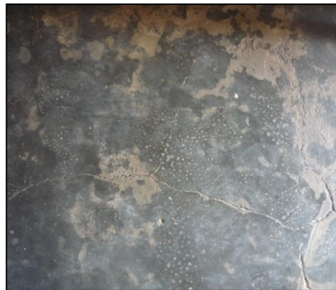
Fotografía 6. Agrietamiento en el piso de vivienda (Casa N°1).
