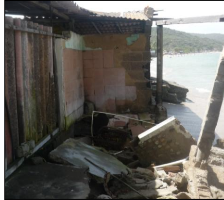
Fotografía 37. Afectación total de la fachada frontal de vivienda (Casa N°1).
