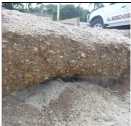
Fotografía 44. Efectos de la erosión costera en el tramo vial afectado.
