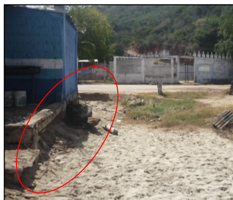
Fotografía 8. Comercio afectado por socavamiento de escurrimiento pluvial.
