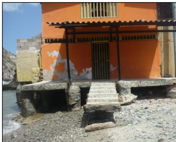
Fotografía 53. Afectación actual (año 2016) a fachada de vivienda.
