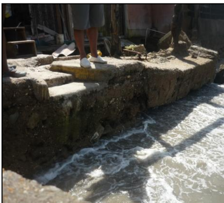
Fotografía 40. Afectación de fachada frontal de vivienda (Casa N°1).
