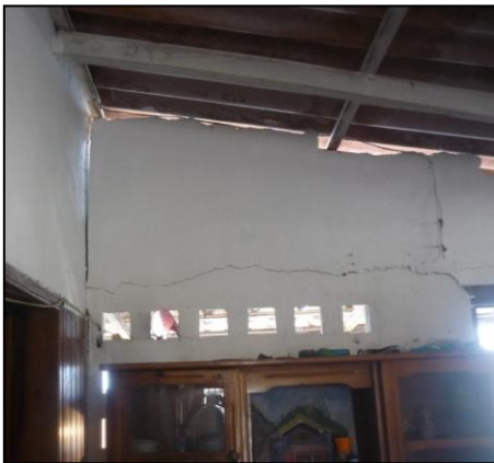
Fotografía 5. Agrietamiento en las paredes de vivienda (Casa N°1).
