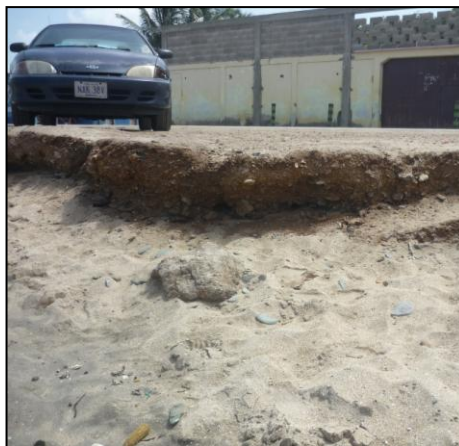
Fotografía 43. Afectaciones en la infraestructura vial.
