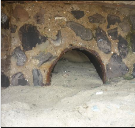
Fotografía 36. Canal construido para el desagüe de la laguna obstruido.
