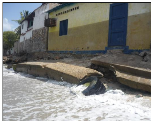
Fotografía 41. Afectación de infraestructuras de viviendas.
