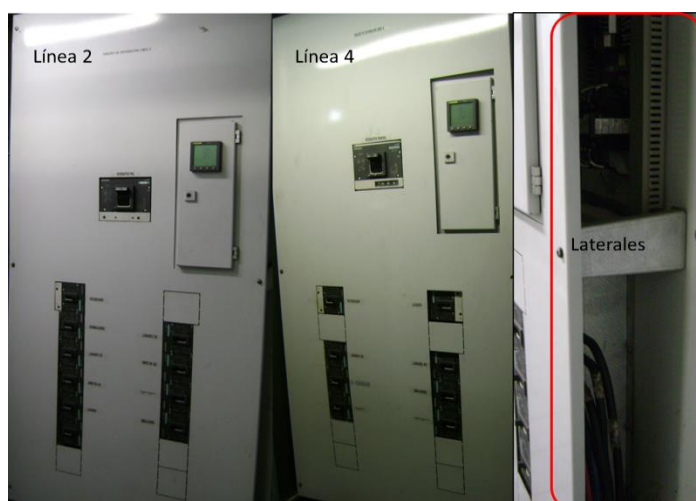
Figura 11. Tableros de las líneas de envasado 2 y 4.
