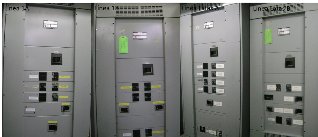
Figura 10. Tableros de las líneas de envasado 1(A y B), Latas (A y B)
