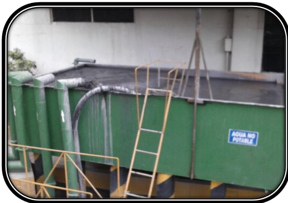
Figura 4.2 Tanque donde descargan las bombas de Aguas. Tomado por la autora.
