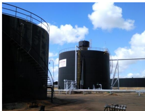
Figura N° 6. Tanques de lavado TK-20.001 y TK-20.002
