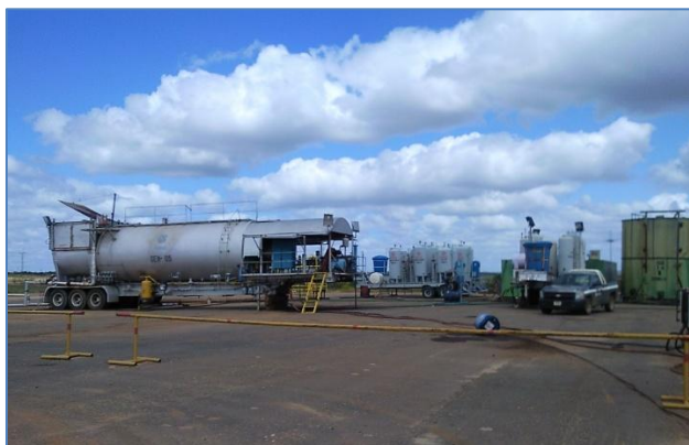
Figura N° 7. Sistema de generación de vapor ubicado en Bare-5
