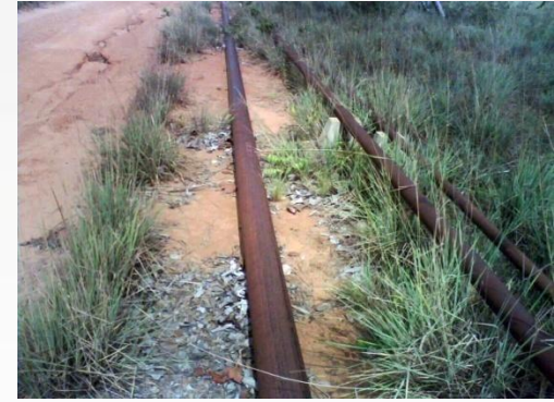
Tubería no soportada
