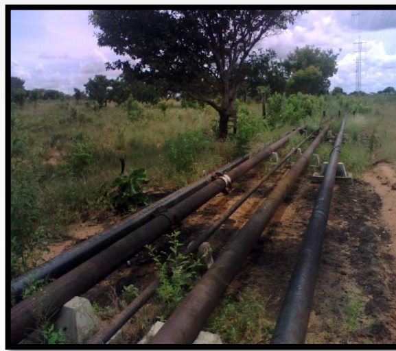
Sistemas de tuberías con fallas por corrosión
