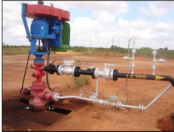
Figura N° 23 Pozo LG-300 Bombeo por Cavidad progresiva (BCP)
