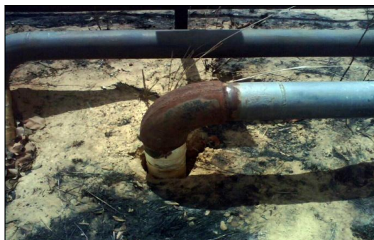
Figura N° 30 Corrección en codo con grampa pozo MS-626
