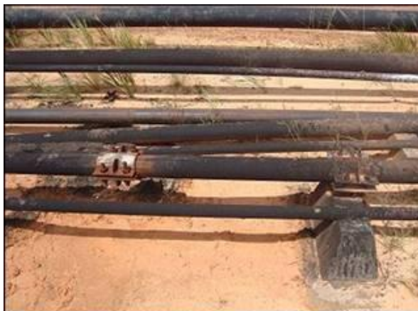
Figura N° 24 Corrección de fugas con camisa apernada. Pozo LG-300
