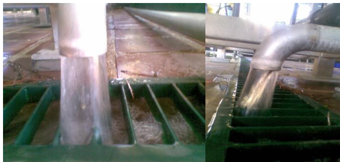
Figura A.3 Drenaje del agua de concentrado a la red de desagüe.
