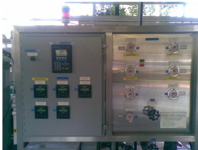
Figura N° 9. Panel de control del sistema de ósmosis inversa
