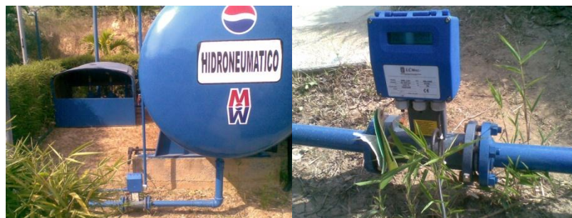
Figura N° 10. Medidor de flujo a la salida del hidroneumático
