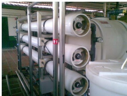
Figura A.2 recipientes a presión del sistema de ósmosis inversa de planta San Pedro con membranas FILMTEC™ bw30-400
