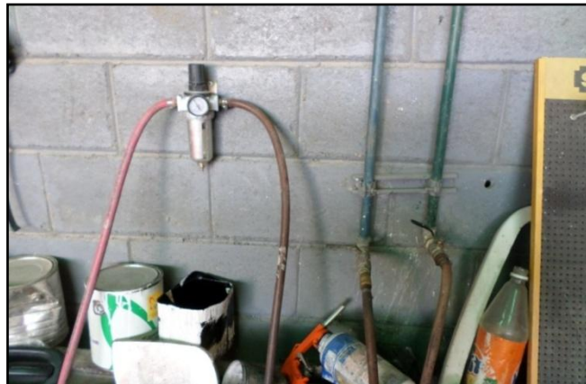
Figura 19. Tubería en el área de trabajo
