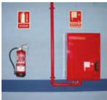
Figura 41. Sistemas de extinción en la pared: extintor y boca de incendios.
