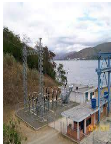
Vista sub-estación de eléctrica Taiguaiguay
