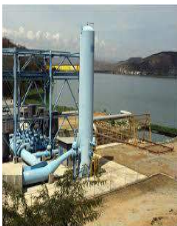
Vista estación de bombeo Taiguaiguay capacidad de los equipos 750 L.s -1
