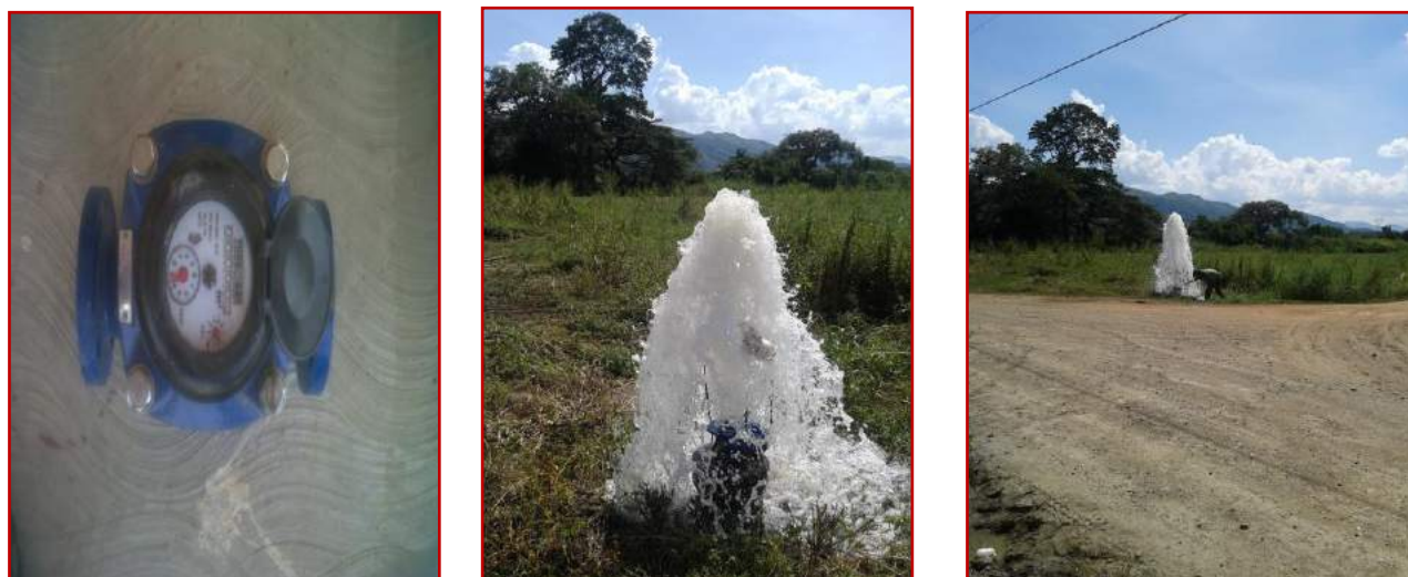
Figura 28. Vista de contador volumétrico instalado y caudal registrado durante la ejecución de la prueba de medición.
