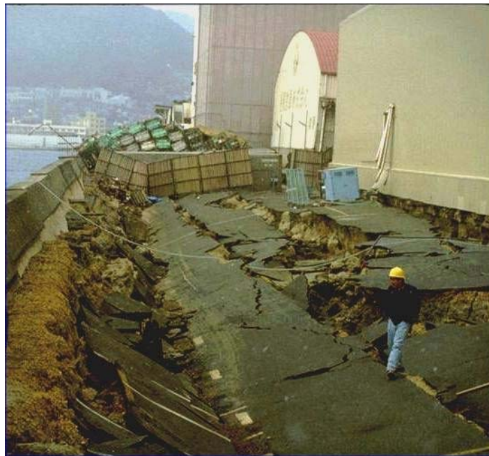
Figura 4. Inestabilidad de muro de sedimentos, Terremoto de Kobe 1995
