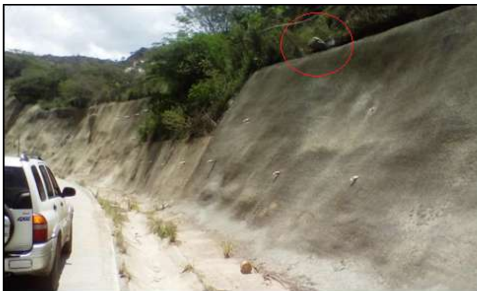
Figura 5.12 Roca retenida en la cerca que separa la cantera y la carretera.
