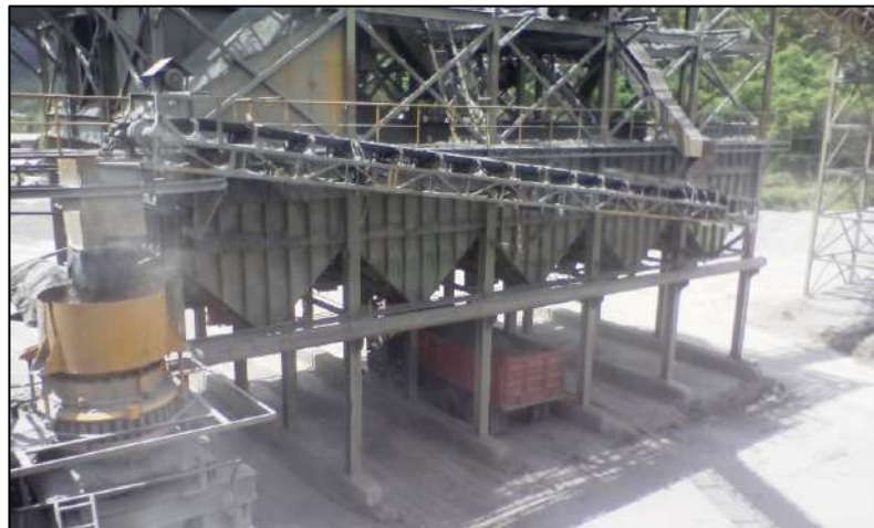
Figura 3.7 Tolvas de despacho de producto final.
