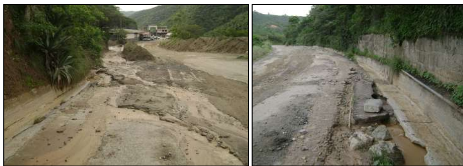
Figura 5.3 Vías internas afectadas por el cauce de aguas.
