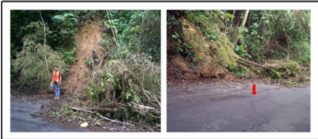
Progresiva: 18+263,3. Izquierda: Deslizamiento ocasionado por fuerte precipitación en talud meteorizado. : Derecha: Grieta de tracción, evidencia del movimiento ocurrido.
