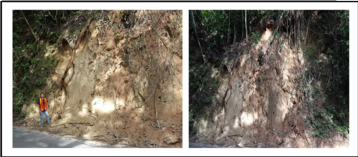
Progresiva: 24+296. Leve deslizamiento ocurrido en el afloramiento. Obsérvese la pendiente casi vertical del talud.
