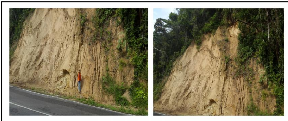
Progresiva: 20+557,4. Talud visto antes de ocurrir una precipitación. Obsérvese las cárcavas.
