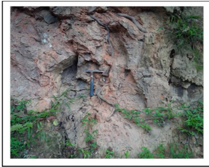
Progresiva: 19+105,2 .Orientación de la foto: N33S: Disgregación de la roca en el macizo rocoso por la alta meteorización presente en la zona.
