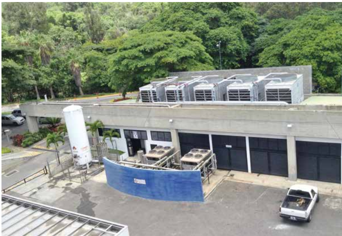
Figura 19: Centro Medico Docente La Trinidad, Caracas. Depósitos de equipos industriales: gases medicinales, caldera, bombas, tanque hidroneumático, aire acondicionado. Foto del autor (2014)
