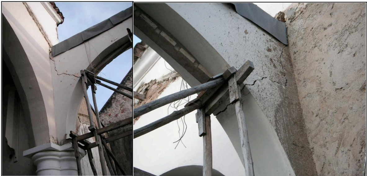
Figura 5. Daños y deterioro estructural en el templo.
