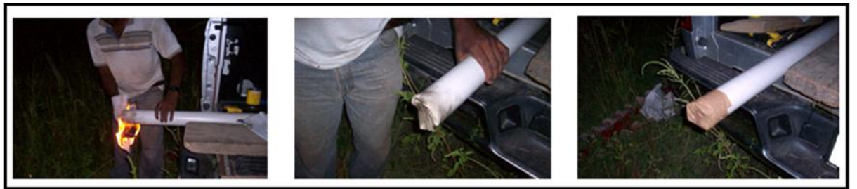
Figura 3.3. Procedimiento para el sellado del tubo antes de ser colocado dentro del pozo.
