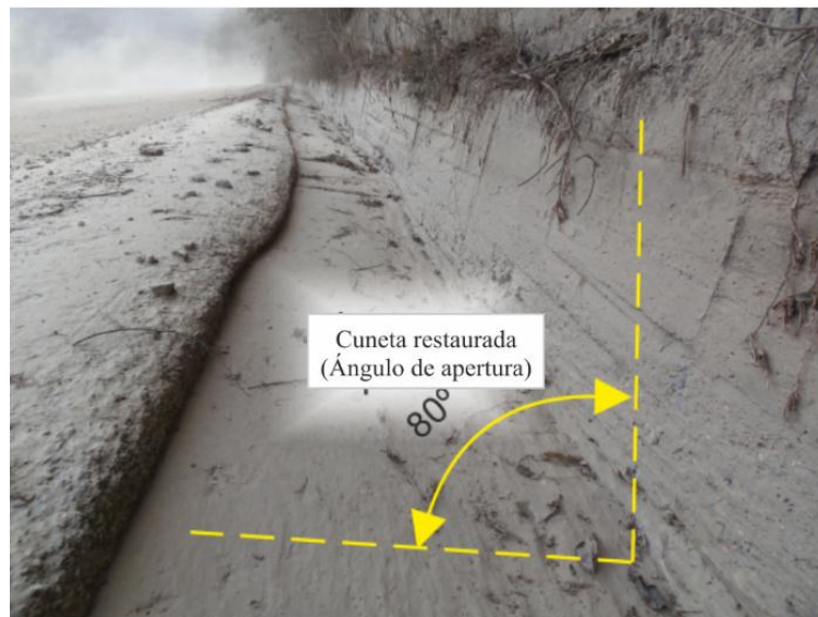
Figura. 65. Despeje de sección de cuneta con obra civil, insuficiente para el manejo de las aguas (Tramo 01). Fuente: Propia (2015).
