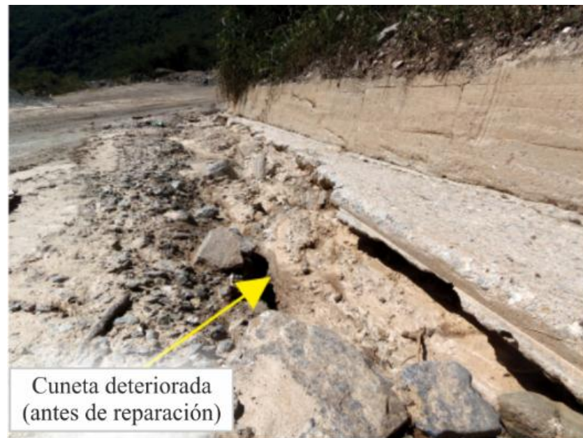
Figura. 62. Deterioro en cunetas registrado en el levantamiento de campo Fuente: Propia (2015).
