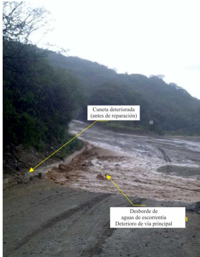
Figura. 63. Desborde de aguas de escorrentía y erosión de vías (Tramo 01). Fuente: Propia (2015).
