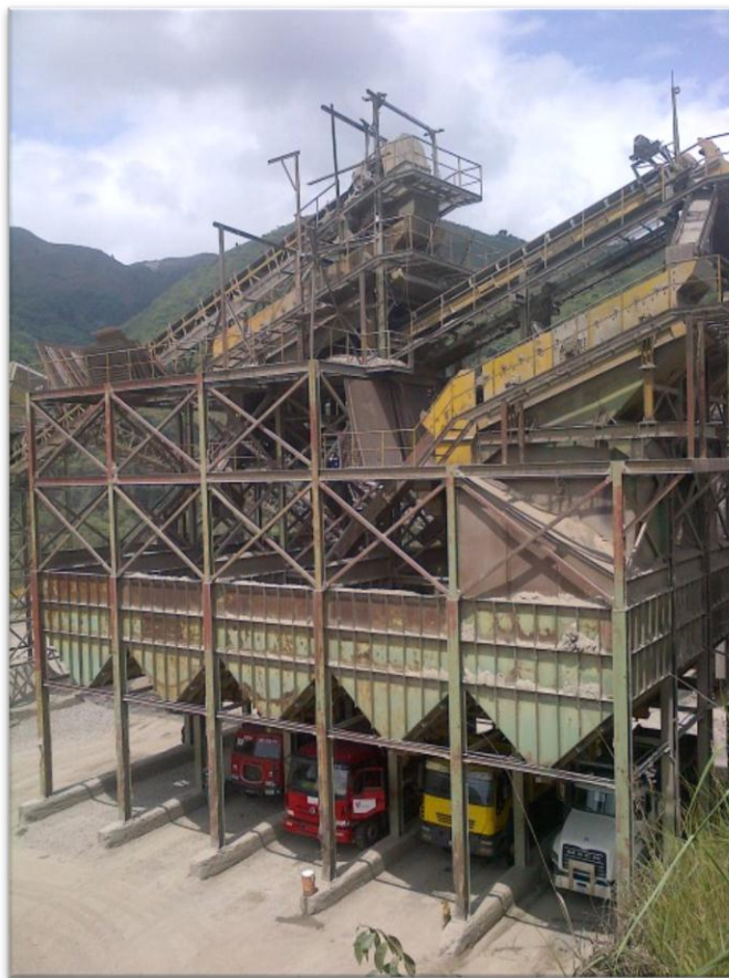
Figura. 45. Tolvas de planta de trituración de agregados II. Fuente: Propia (2015).
