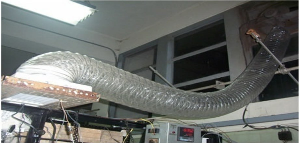
Figura N° 19. Sistema de ventilación.
