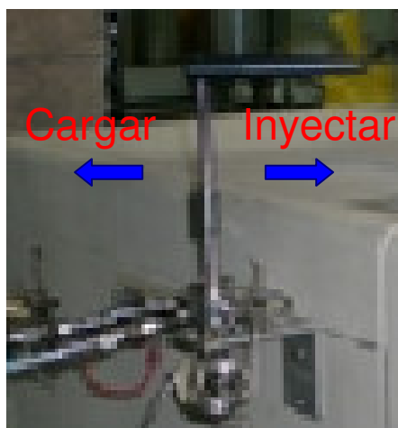
Figura N° C. 9. Válvula de inyección.
