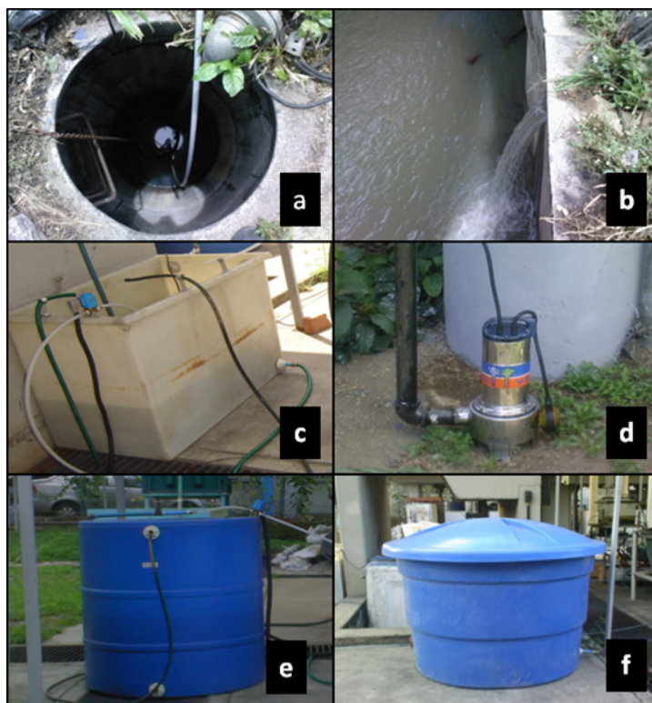
Figura 11: Sistema de Mezclado. (a) Pozo de Bombeo. (b) Colector Marginal Izq. Río Valle. (c) Tanque de Mezclado. (d) Bomba sumergible. (e) Tanque de almacenamiento de agua residual. (f) Tanque de almacenamiento de agua de mar.
