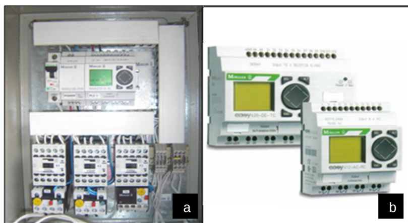
Figura 15: Sistema de Automatización. (a) Cajetín eléctrico. (b) Módulo de control.
