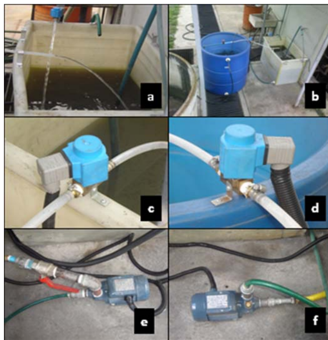
Figura 13: Sistema de válvulas, bombas y tuberías. (a) Tuberías, electroválvula y bomba sumergible. (b) Tanques y tuberías. (c) Electroválvula para la alimentación de agua de mar. (d) Electroválvula para la alimentación de agua residual. (e) Bomba de recirculación. (f) Bomba de alimentación de agua de mar.
