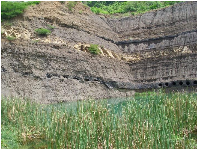
Figura 11. Mantos de carbón expuestos en el talud de Fila Maestra.
