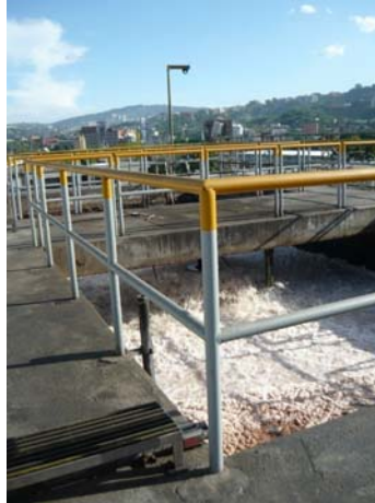
Figura A-1. Tanque de Igualación – Compensación (Tanque Buffer), que opera en Productos EFE.
