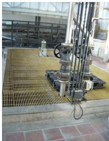
Figura A-2. Tanque de Neutralización, que opera en Productos EFE.
