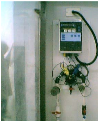
Figura N° 4: Equipo Clorinador de dosificación que posee actualmente la empresa
