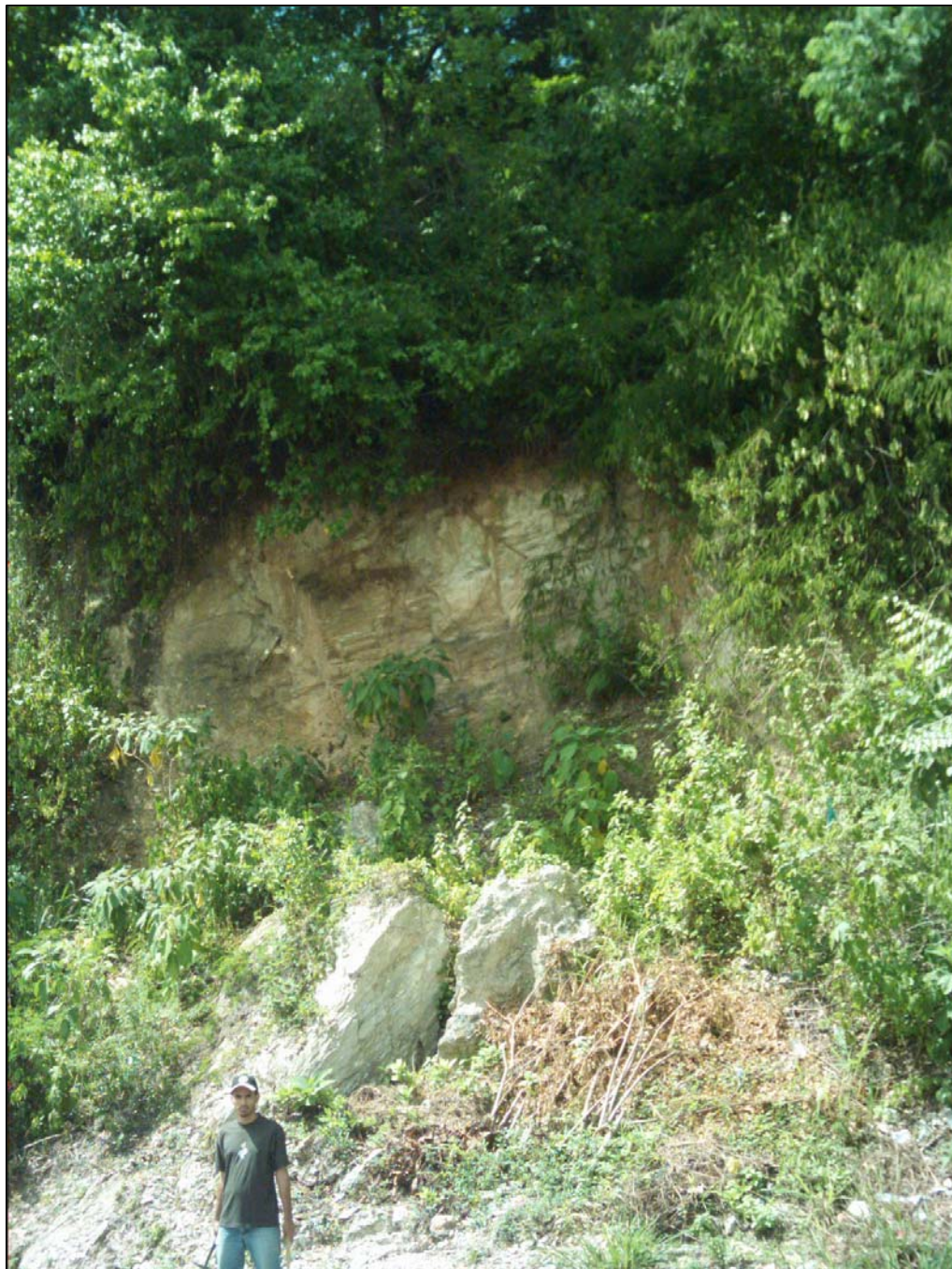
Figura 124: Caído de bloques donde el material involucrado está compuesto por una combinación de bloques grandes de roca y detrito. Se observa zona de acumulación al pie del talud. Proceso reportado en la carretera Las Brisas. Rumbo N10°W.
