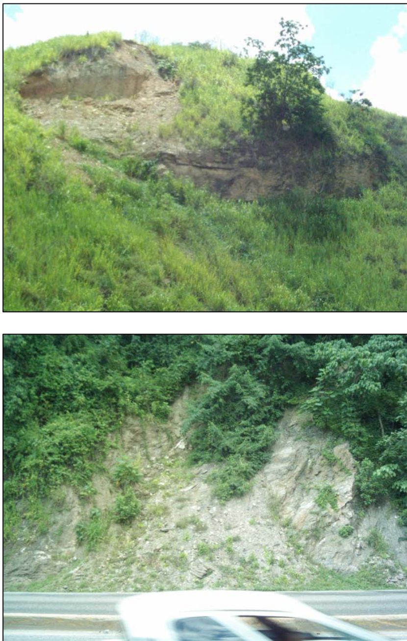
Figura 122: Caído de bloques donde el material involucrado está compuesto por una combinación de suelo y detrito. Se observan zonas de acumulación al pie del talud y vegetación en las coronas y partes bajas de los deslizamientos. Procesos reportados en la autopista Caracas-Valencia. Arriba: Rumbo N60°E. Abajo: Rumbo N35°W.
