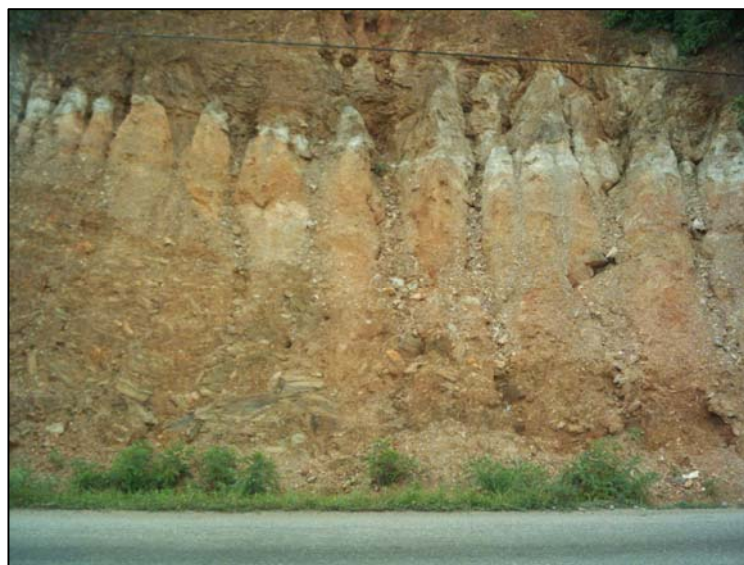
Figura 128: Cárcavas presentes en el carretera hacia Las Brisas del Tuy. Rumbo N30°W.
