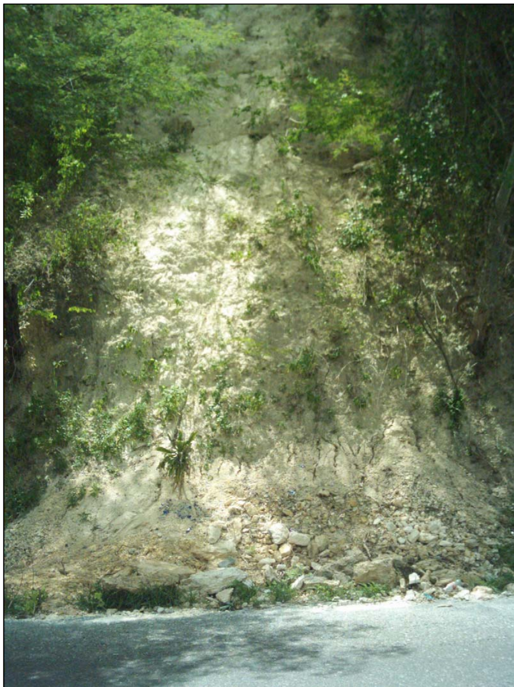
Figura 125: Caído de bloques donde el material involucrado está compuesto por una combinación de roca, detrito y suelo. Se observa zona de acumulación al pie del talud. Proceso reportado en la carretera Las Brisas. Rumbo N30°W.
