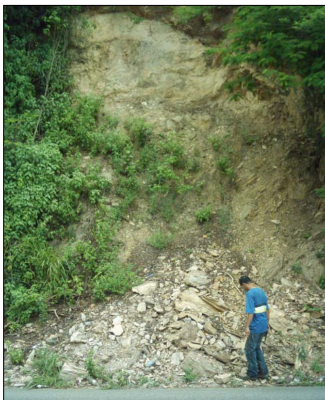
Figura 123: Caído de bloques donde el material involucrado está compuesto por una combinación de roca, detrito y suelo. Se observan zonas de acumulación al pie del talud. Procesos reportados en la carretera Las Brisas. Arriba: Rumbo N27°E. Abajo: Rumbo N25°E.
