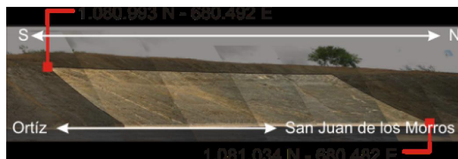
Foto 9. Se muestra el paquete # 4 dentro del afloramiento # 4, con sus respectivas coordenadas de inicio-final y el sentido referencial San Juan de los Morros-Ortíz.
