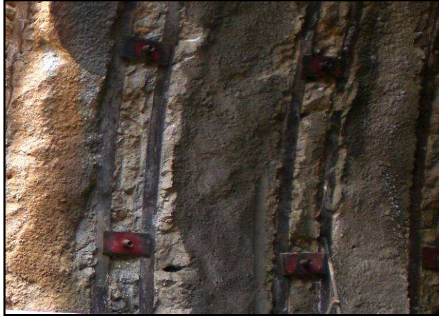
Foto 22. Pernos colocados en el hastial izquierdo del túnel San Juan, distancia entre pernos 1 m. Foto por: Luis Zurbarán
