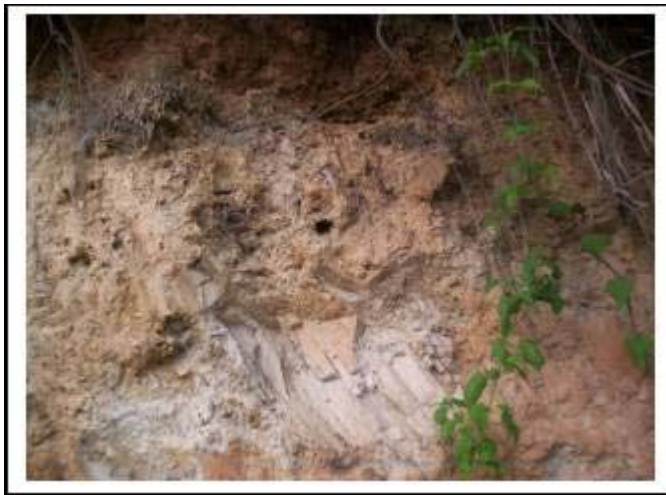
Foto 12. Talud 11. Metaconglomerado suelo residual muy saprolitizado.
