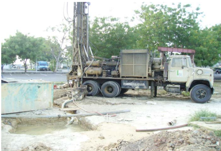
Figura 14: Vista de la fosa de lodo, canal de circulación y ubicación de equipos.
