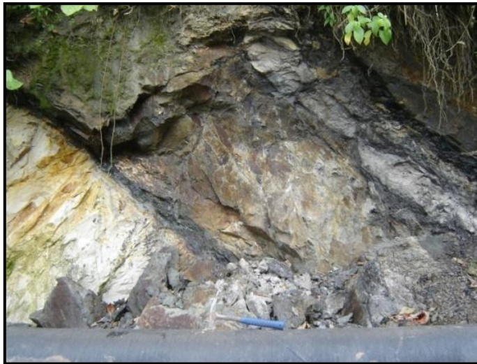
Figura 4.7 Areniscas de la Formación Barco aflorantes en la vía de Macanillo. Se pueden apreciar las capas delgadas de carbón
