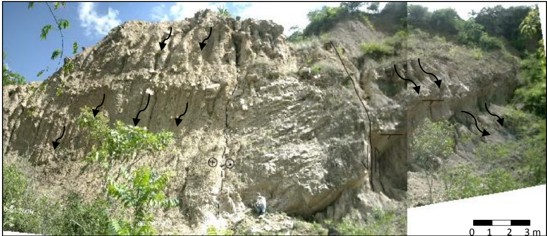
Figura N°5.58 Afloramiento de la estación FC-014. Las líneas continuas representan fallas, la segmentada falla asumida, las flechas curvas zona de carcavamiento. Orientación de la fotografía ( 60^\circ ).
