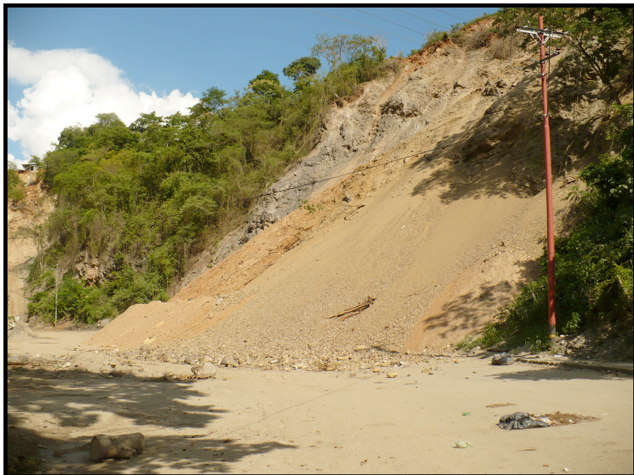
Foto N° 25. Vista en perfil del flujo torrencial continuo que presenta el talud.
