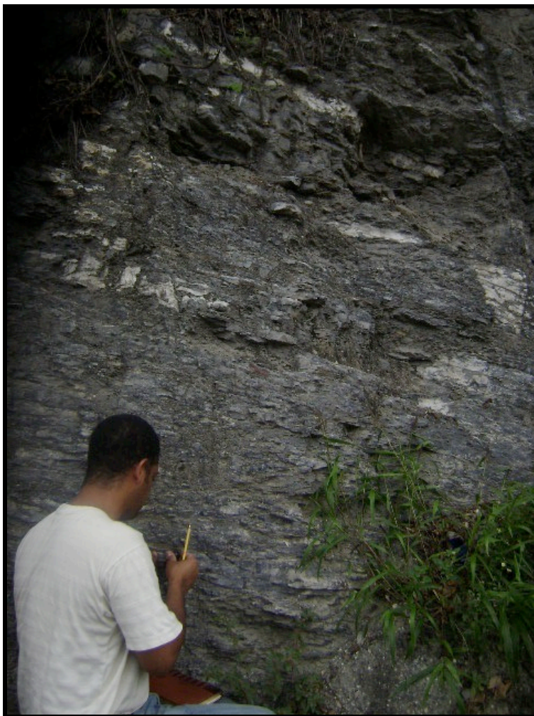
Foto N° 20. Evidencia de foliación, y presencia de vetas de calcita en la parte superior del talud.
