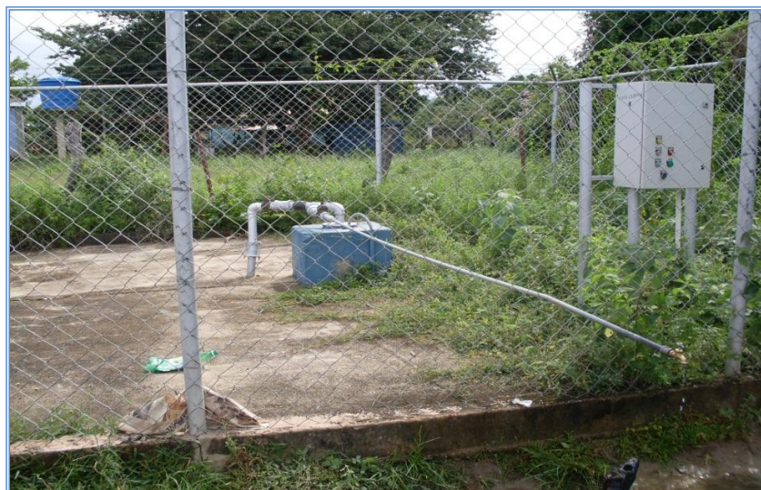
Figura 35. Foto donde se observa la condición del pozo El Bolivariano
