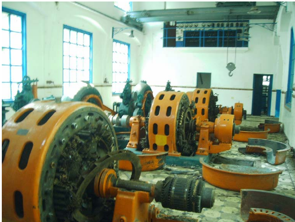
Figura 5 Equipos electromecánico desmantelado. Fuente Propia
