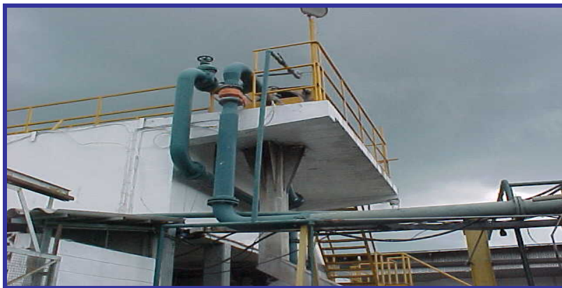
Ilustración N° III-3. Tubería de Bombeo hacia la Criba.
