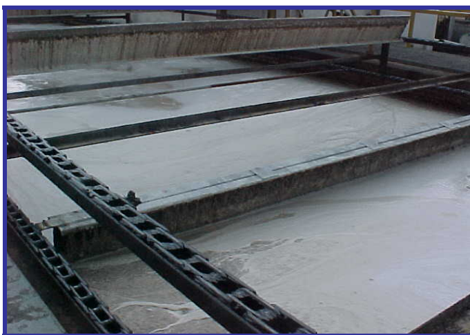
Ilustración N° III-6. Unidad de Flotación por Aire Disuelto.
