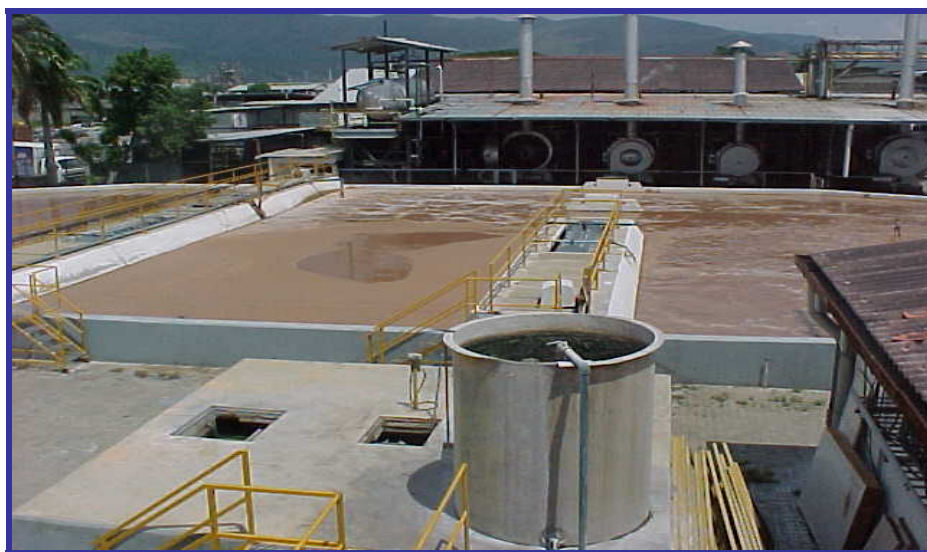
Ilustración N° III-7. Canal de oxidación.
