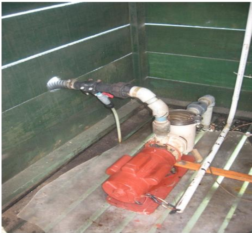
Figura 3. Bomba de agua.
