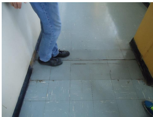
Figura 4.15. Deterioro de la Junta de Dilatacion Eje 13 Piso 3.
