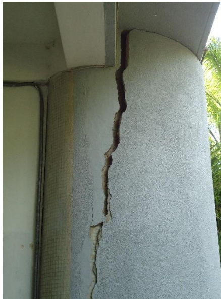
Figura 4.15. Deterioro y desprendimiento de recubrimiento en columna de PB.
