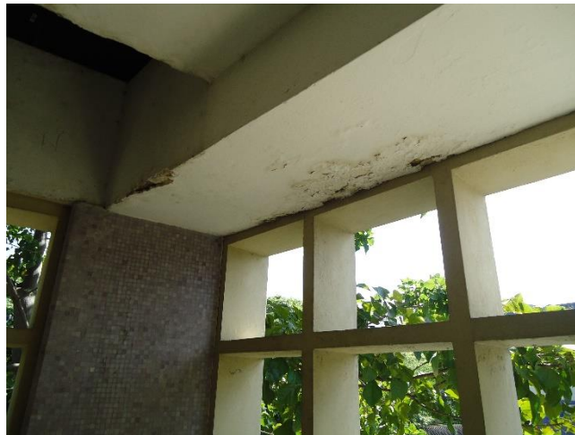
Figura 4.14. Humedad en Viga 4V11.
