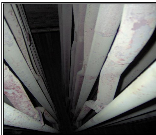
Figura 50. Tubos del sobrecalentador de la caldera BL-61-3. (Octubre 2006)
