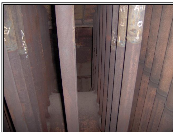
Figura 51. Tubos del sobrecalentador de la caldera BL-61-3. (Octubre 2006)
