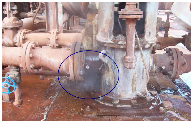
Figura 37. Fuga de vapor I en el área de Evaporación.
