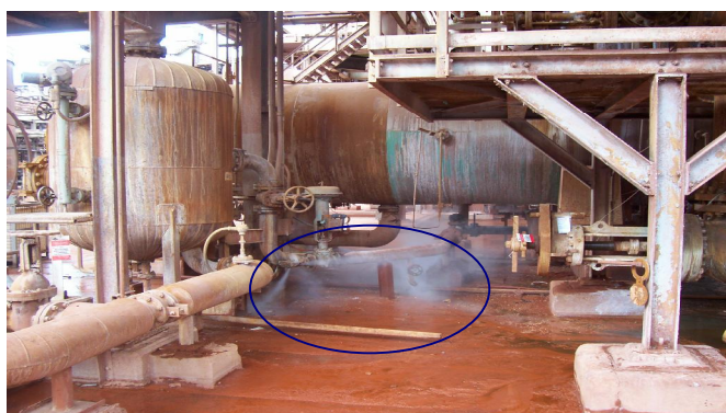
Figura 38. Fuga de vapor II en el área de Evaporación.
