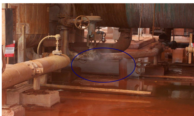
Figura 39. Fuga de vapor III en el área de Evaporación.
