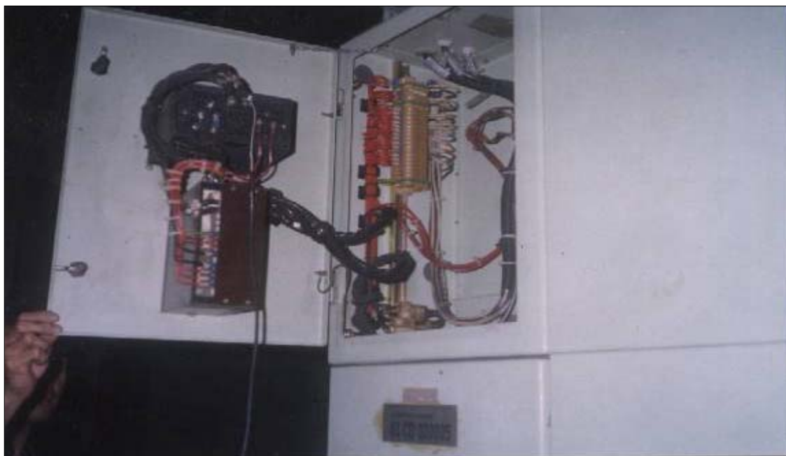
Fotografía 3.1 Conexión en el shunt de los disyuntores de vía y tramo de la sub-estación la corriente de tracción.
